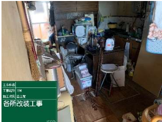
床が傷んでではがれていて踏きそうで危ない
