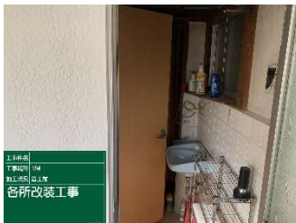
トイレのドアが洗面台にあたって不便
