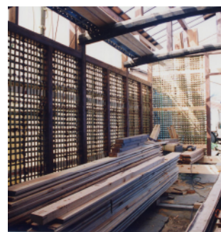
建物全体の構造補強例 (耐震の弱点・吹抜けトオリニワ)
